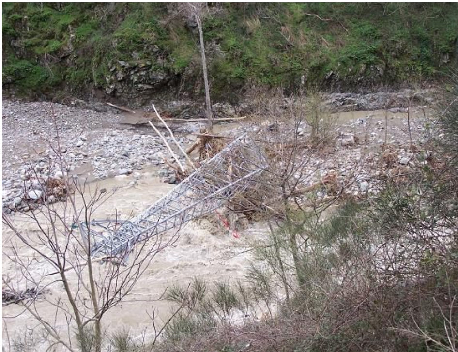
Calabria – fiume Savuto – traliccio crollato nel letto del fiume: http://www.savutoweb.it/wordpress/?p=3954
